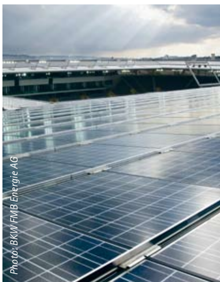
Photovoltaic facility on the roof of Stade de Suisse, Berne
